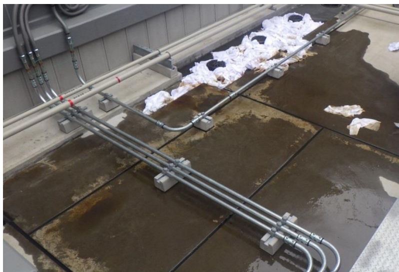
屋上への重油の流出状況
