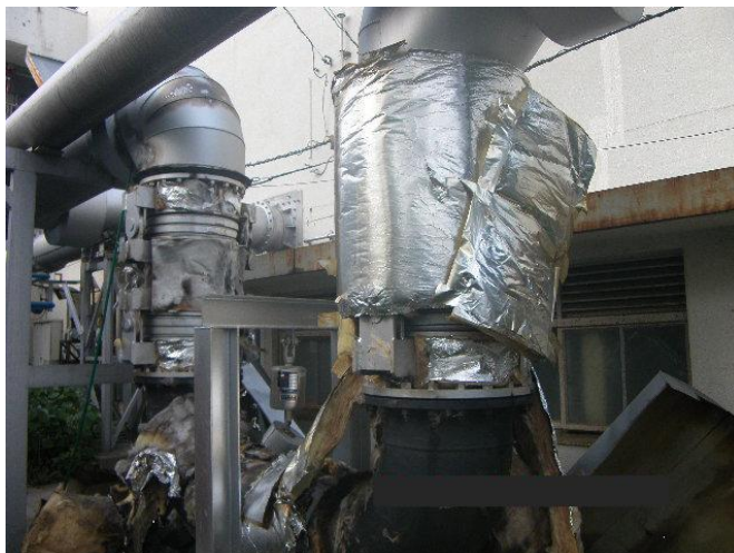
空気配管の接続部分
