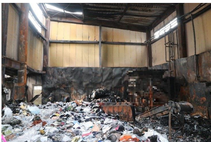
作業所内の焼損状況
