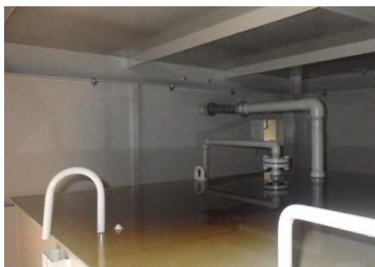
サービスタンクからの流出状況
