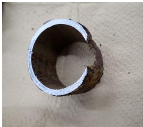
腐食により減肉した状況（配管断面）
