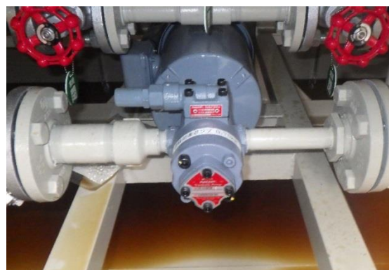
返油ポンプの状況
