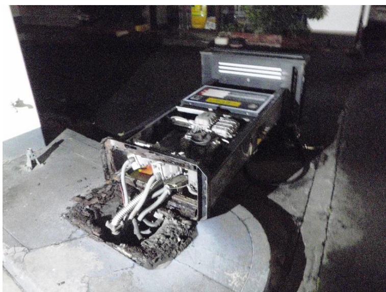
転倒した固定給油設備
