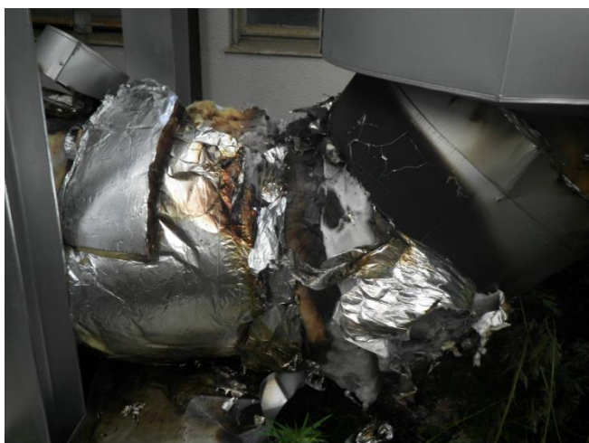
焼損した保温材
