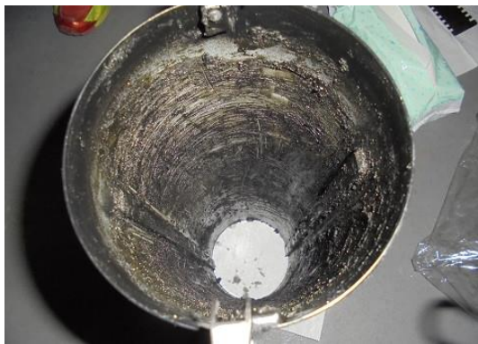
写真6-118 着火後のダクト内部 可動ダクトを上方より撮影
