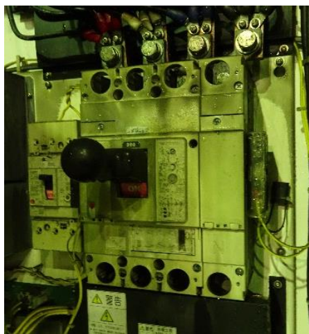
写真 6-10 漏電遮断器(100mA、0.1 秒)の作動状況
