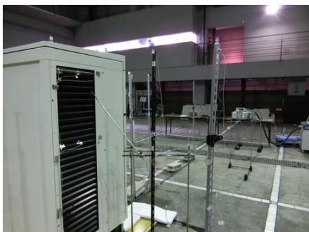
写真 6-20 ガス採取パイプ
