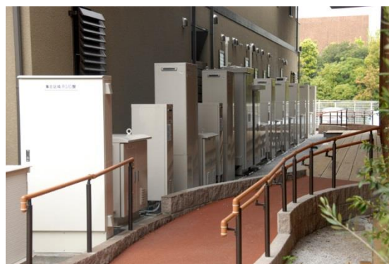
図 3.1.2-4 北九州水素タウン設置の 700W 純水素燃料電池
