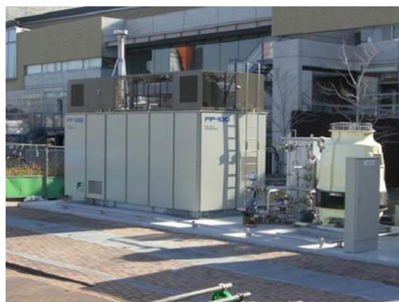
図 3.1.2-3 北九州水素タウン設置の 100kW 純水素燃料電池（りん酸形）
