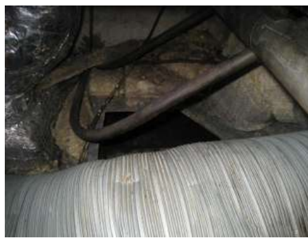
天井内狭隘でアクセスできない様子
