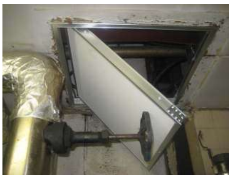
天井点検口が開口できない様子
