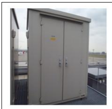
写真 2-1 パワコン (屋外)
