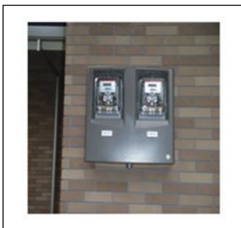
写真2-5 買電・売電用積算電力量計
