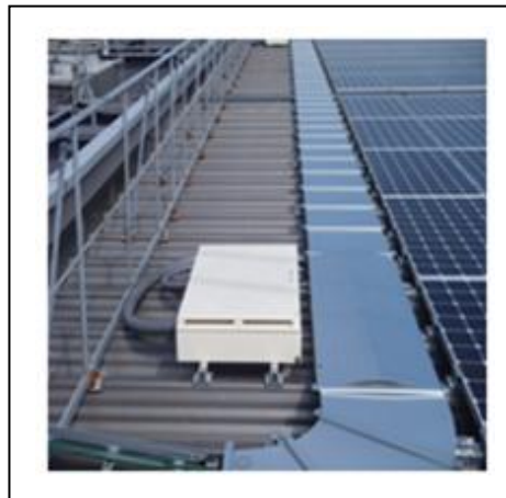
写真2-4 接続箱（PVモジュール横）
