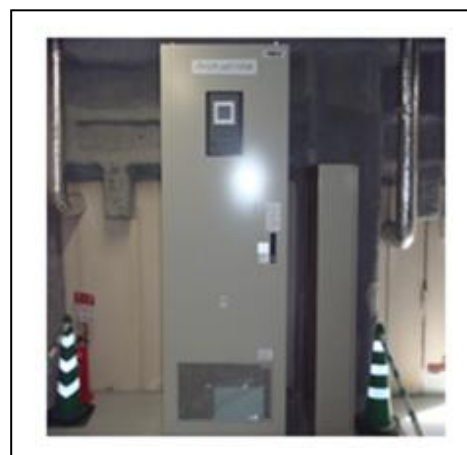
写真 2-2 パワコン (屋内)
