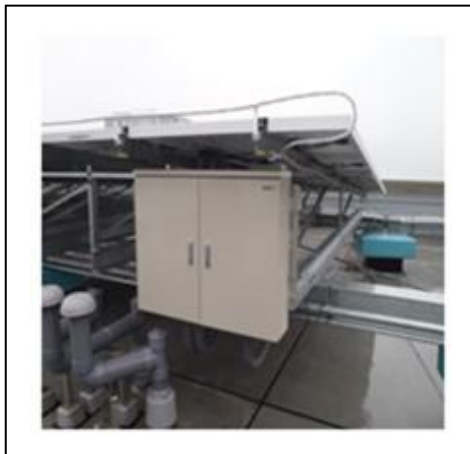
写真2-3 接続箱（PVモジュール下）
