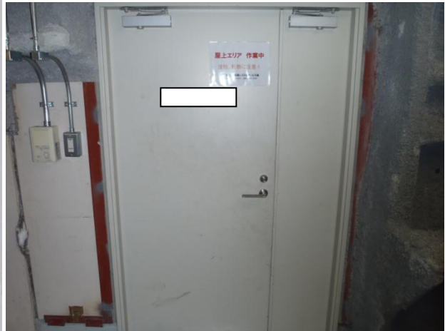
写真7-13 パワコン設置室（電気室）入口の例
