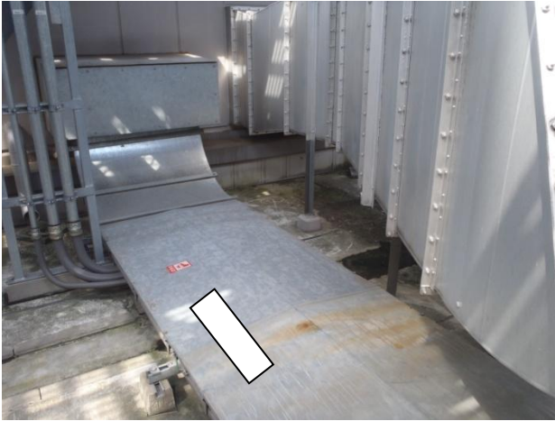
写真7-10 屋上ケーブルダクトの例
