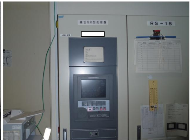
写真7-15 自動火災報知設備受信機の例
