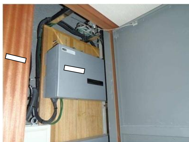
写真 7-6 EPS扉内パワコンの例
