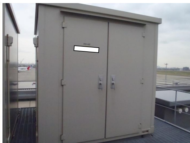
写真 7-5 屋外用パワコンキュービクルの例
