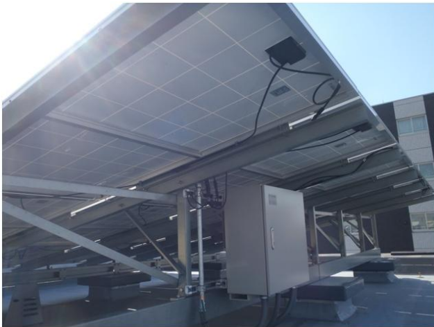
写真7-16 表示が緩和される例 (PVモジュールと近接している接続箱)
