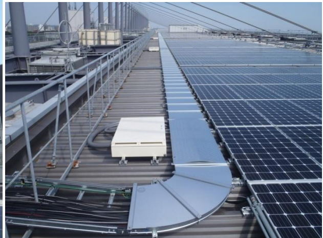
写真7-17 表示が緩和される例 (PVモジュールと近接している配線、ケーブルラック、接続箱)
