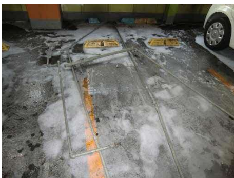
泡流出事故の例
